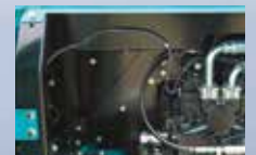
• Brandschutzwand zwischen Pumpen- und Motorraum
